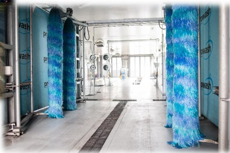
Nowa myjnia w Stacji Obsługi Autobusów Wola Duchacka
